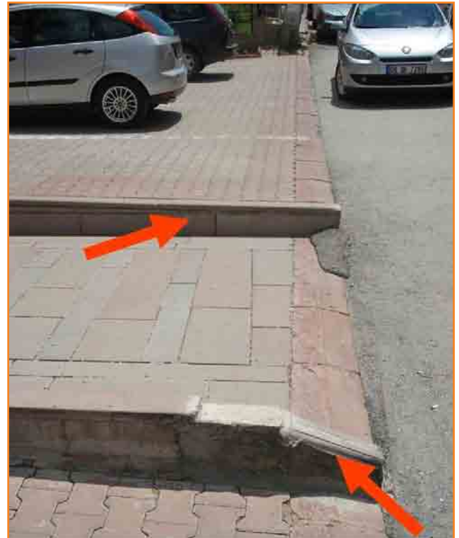
Bina önü otopark sınırını ayırmak için kaldırım engelli ve kullanılamaz hale getirilmiş.
