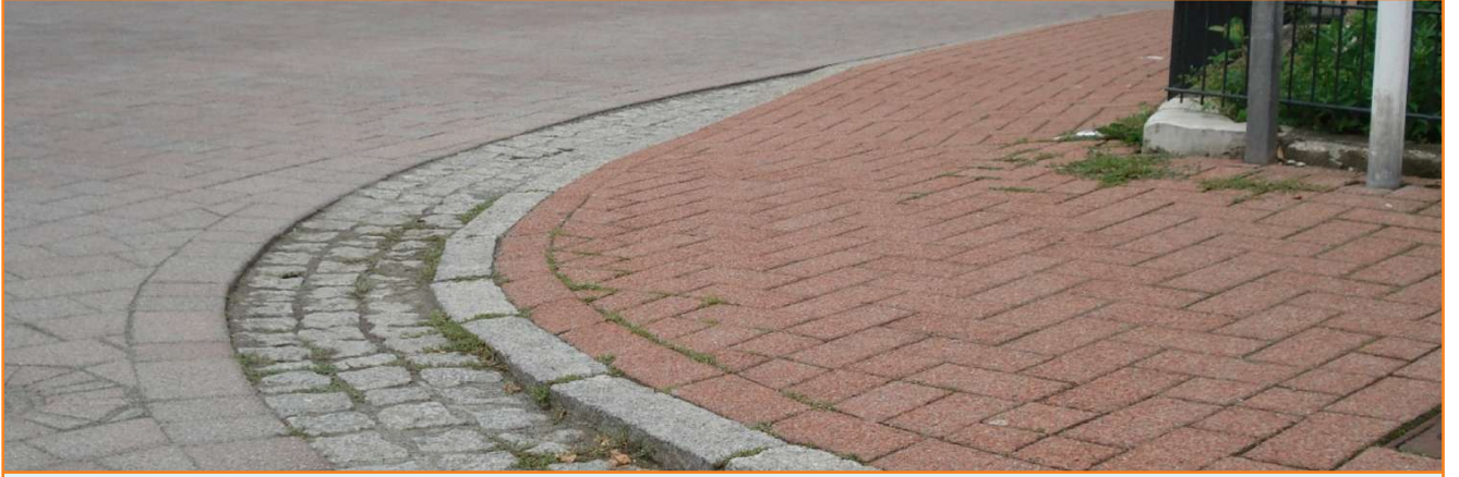
Kaldırım bitişleri yola doğru alçaltılmalıdır.
