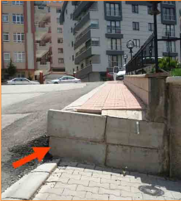
Kaldırım bina parsel sınırlarında bitmiş ve yaklaşık 60cm. lik bir kot farkı yaratılmış. Tamamen yanlış bir düzenleme...
