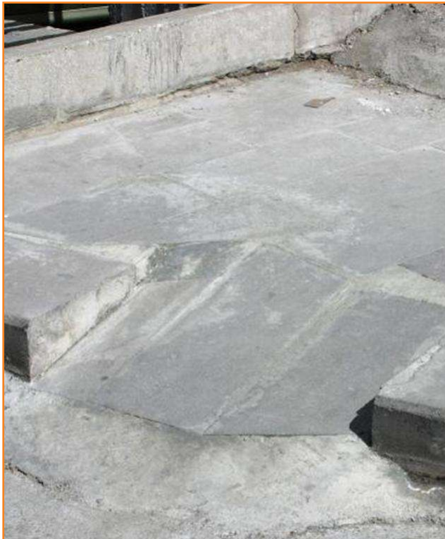
Yanlış bir rampa.
