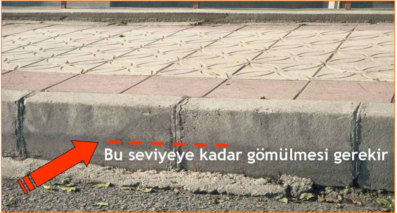
Standartlara uygun olmayan kaldırımlar.
