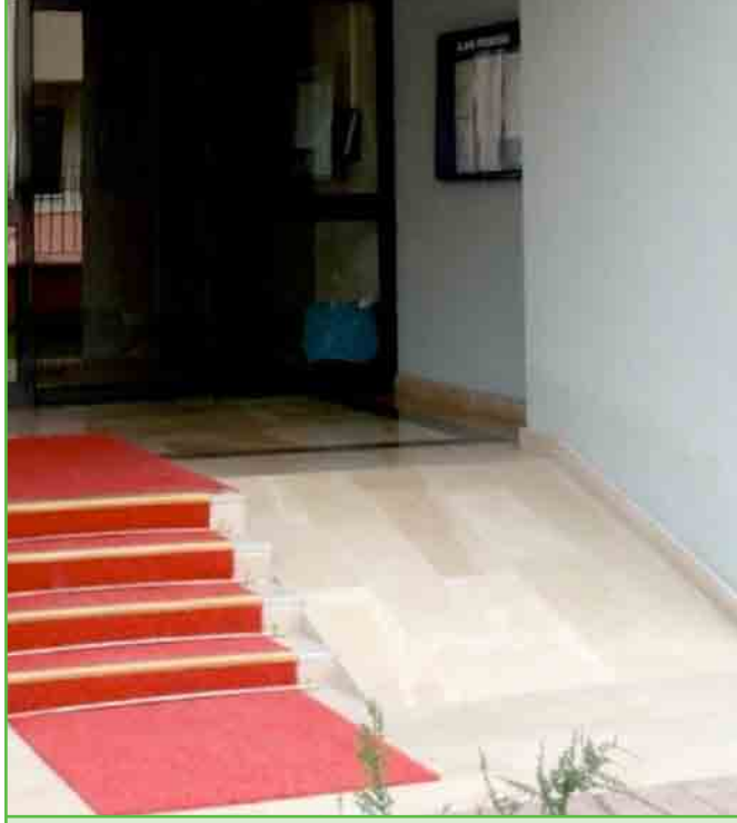
Tamamen yanlıř eęim ve yanlıř malzeme ile yapılmıř bir giriř rampası.
